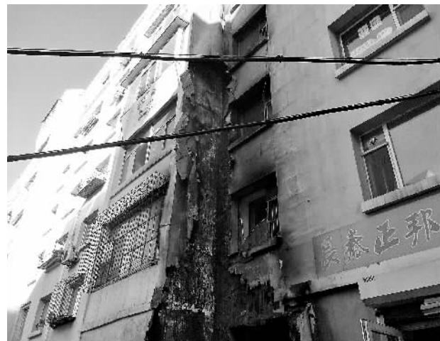
一楼到四楼的楼体保温层被烧毁 新文化记者 邓胜男 摄
