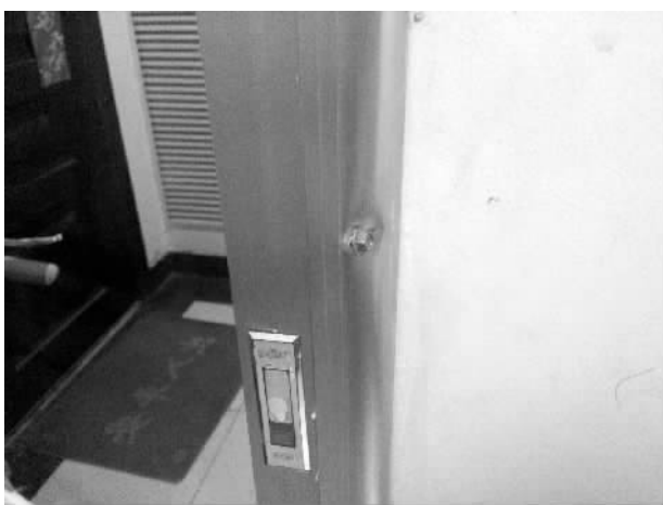
消火栓被封死了 实习记者 马玉轩 摄
